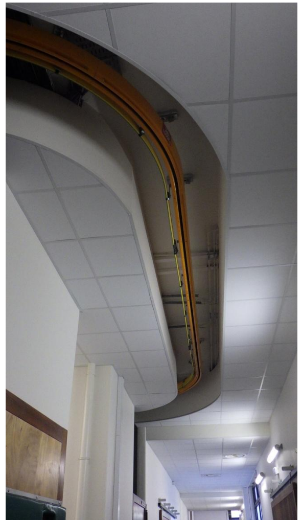
Le rail de circulation entre la salle de préparation et la salle de scanner
